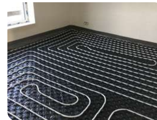
» Chauffage par le sol partout
